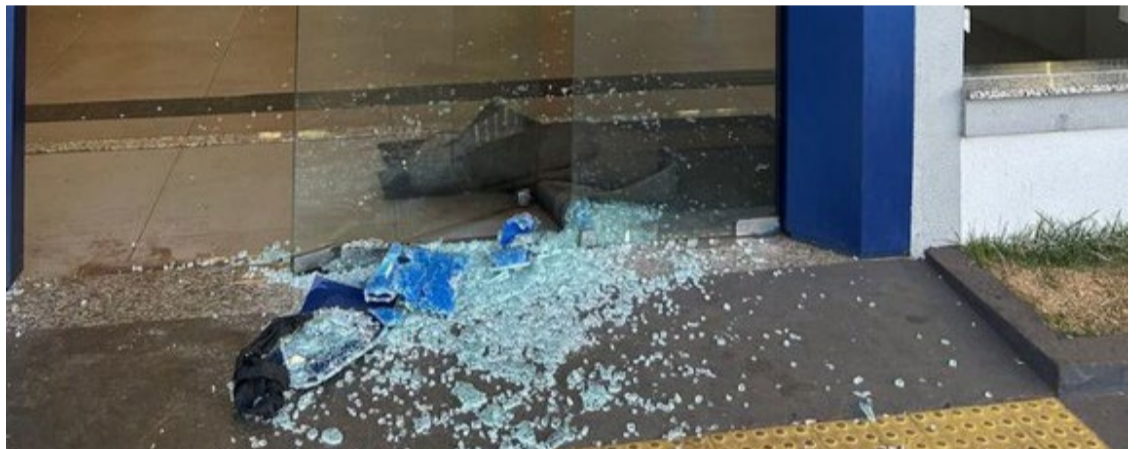
Porta da agência da Caixa em Jataí, danificada após tentativa de furto na madrugada desta quarta-feira, 31/8 — Foto: Reprodução.
